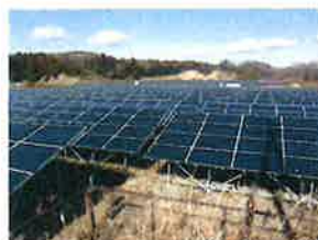
太陽光発電 (茨城県那珂市)
